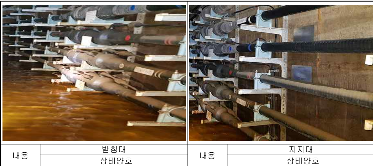
【사진 2.4】 부속 및 부대설비 현황
