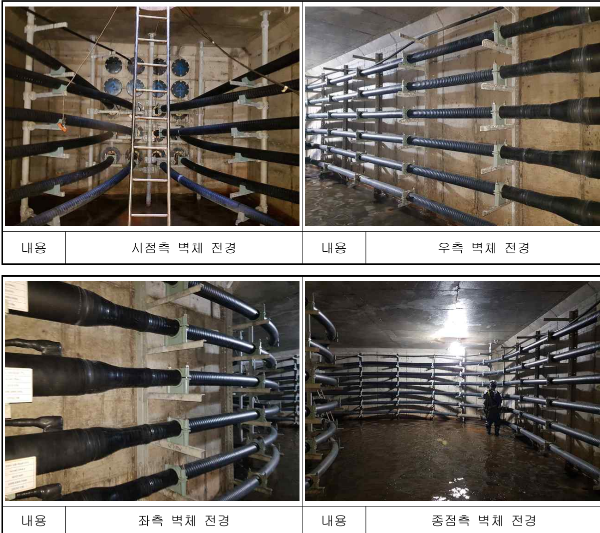
【사진 2.13】 신장~덕소#2 전경
