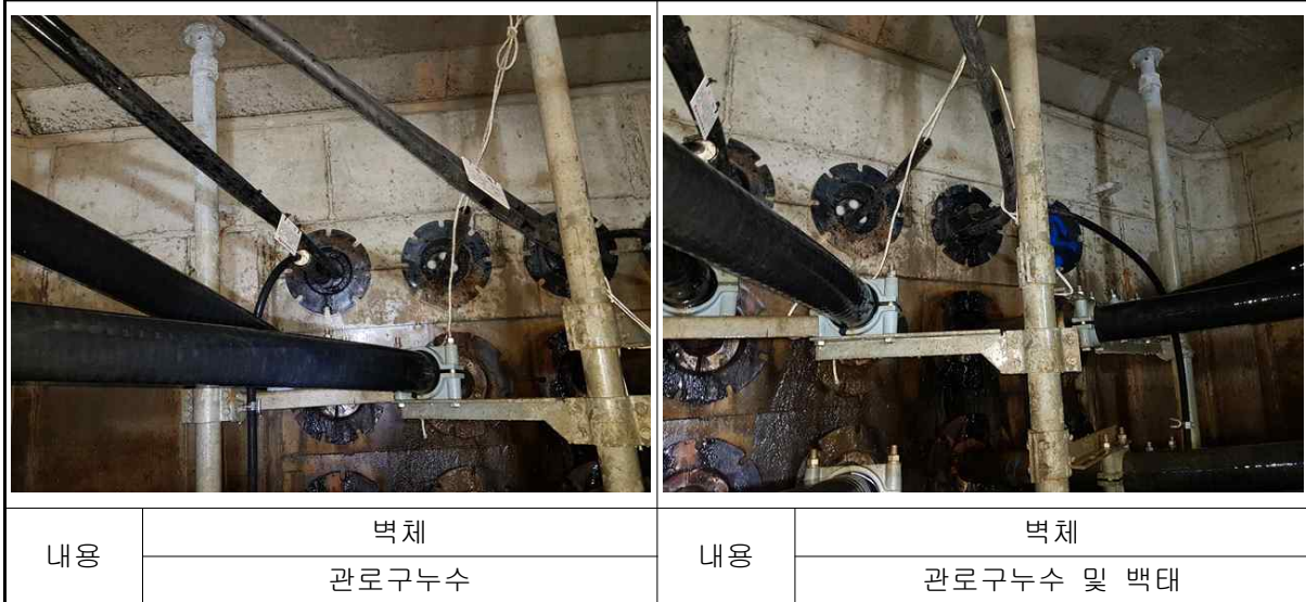
【사진 2.2】 맨홀 내부 주요 손상
