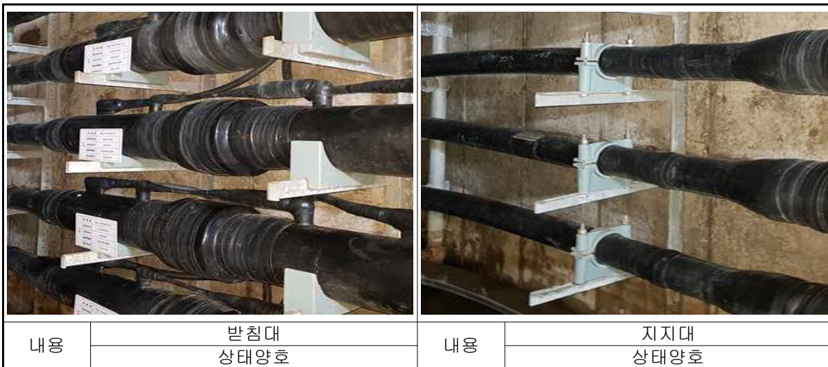
【사진 2.12】 부속 및 부대설비 현황
