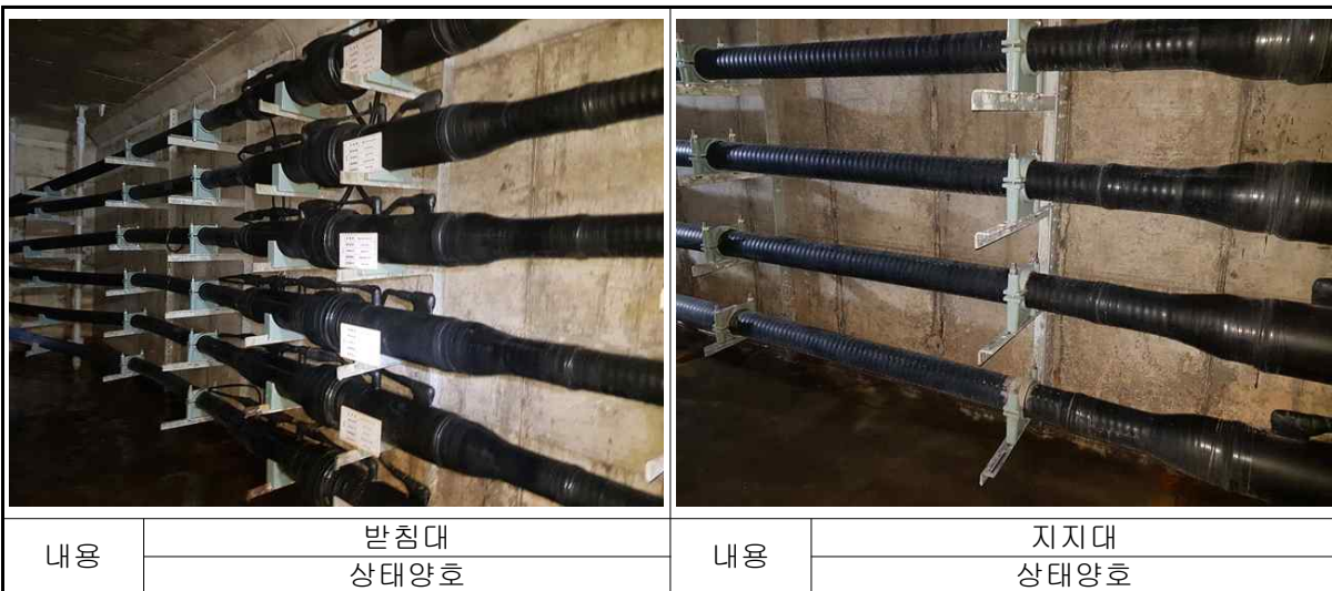
【사진 2.16】 부속 및 부대설비 현황
