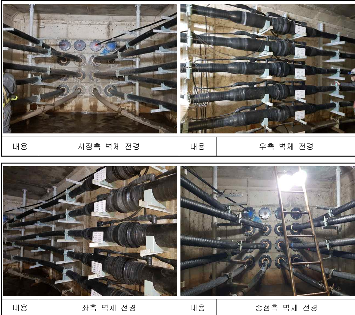
【사진 2.9】 신장~덕소#1 전경
